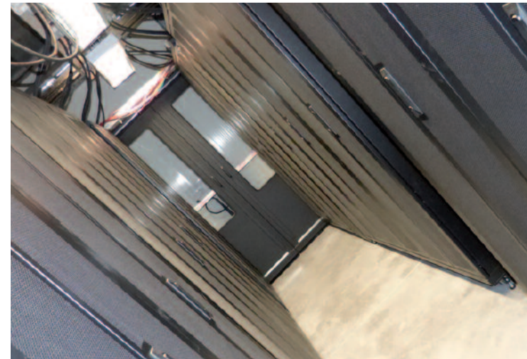
Les serveurs sont installés dans des baies de ce type
